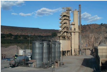
Figura 1.6. Planta de aglomerado asfáltico en caliente.
